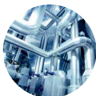
Stadsverwarming en -koeling
